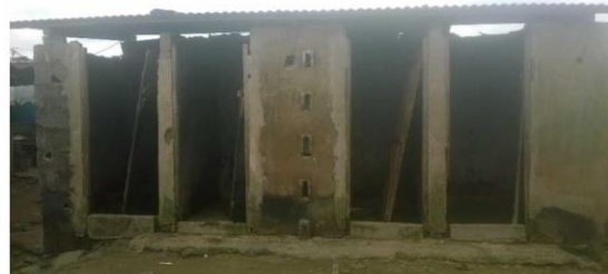
Latrine délabrée encore en utilisation
